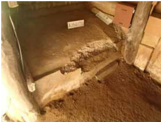
三和土劣化時の状況
