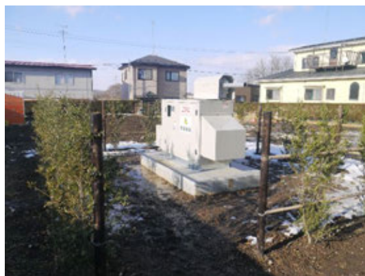
非常用発電機設備の設置状況
